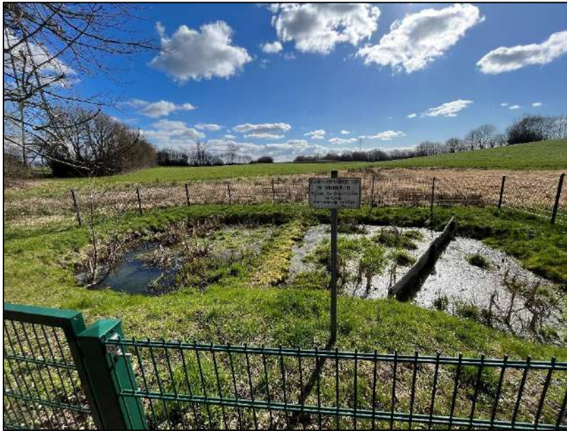
Abbildung 4: Regenrückhaltebecken (Foto: ALSE 03.04.2023)
